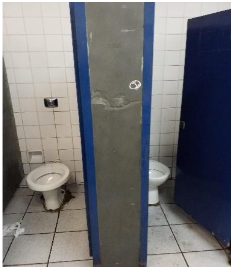
Figura 13 – Falta de assento nos vasos sanitários
