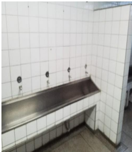
Figura 15 – Falta de suporte para papel toalha e sabonete líquido
