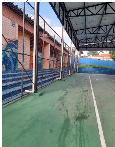
Figura 6 - Tubulação das instalações hidráulicas realizadas na EMEF Dr. Habib Carlos Kyrillos.
