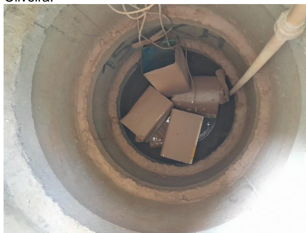
Figura 8 - Reservatórios com resíduos da obra no seu interior - EMEF Profª Amélia Rodrigues de Oliveira.
